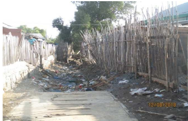
Cliché n°7 : Canal d'évacuation bouché
